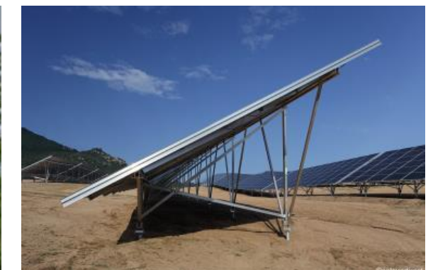
Photo 2 : Structures de support avec modules
