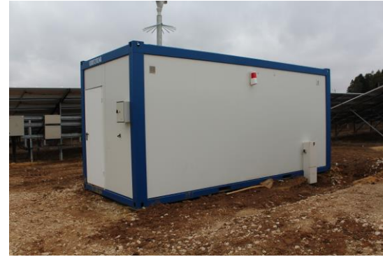
Photo 7 : Exemple de poste de contrôle
