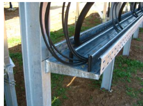
Photo 9 : Câblage entre les modules
